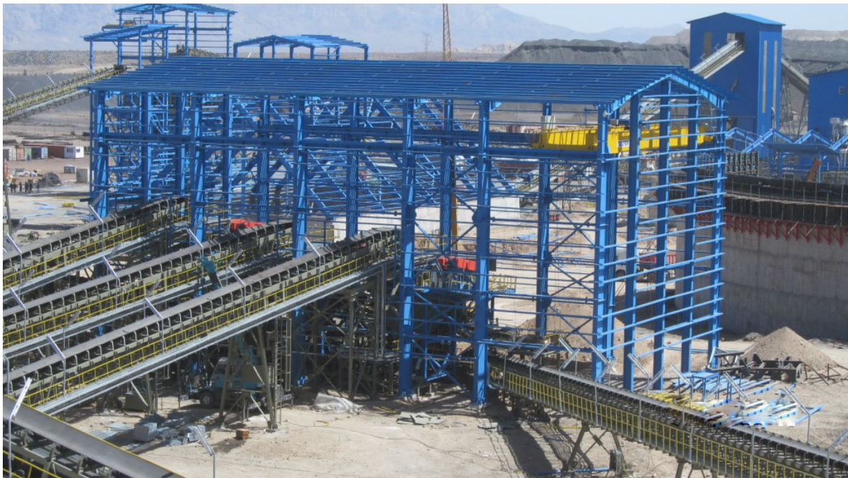
سازه سرند و کانوایرهای پروژه پلی کام (گل گهر سیرجان)
